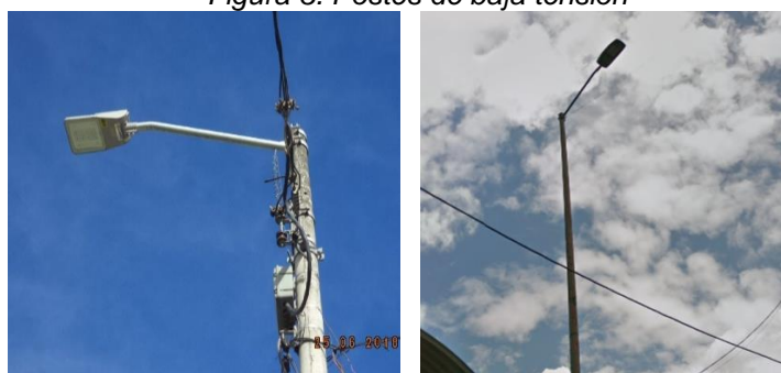
Figura 3. Postes de baja tensión
