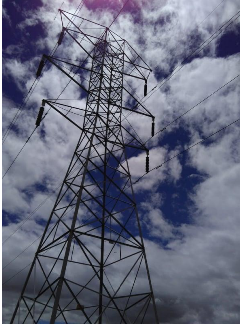
Figura 1. Torre de alta tensión
