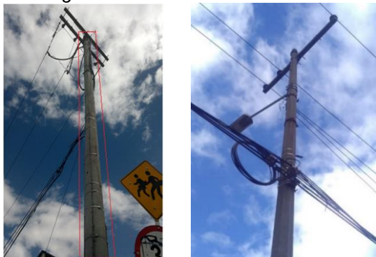
Figura 2. Postes de media tensión
